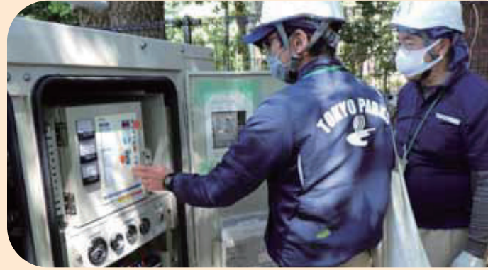
非常用発電機
