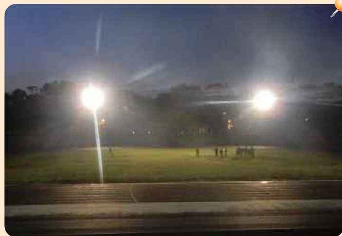
ヘリポート予定地の夜間照明点灯テスト
