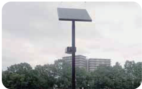
防災用照明灯 (ソーラー照明灯)
