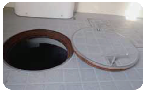
防災トイレ (常設) 地下に便槽を持ち、災害時に給水や排水などのインフラが寸断された場合でも利用できるトイレです。災害時には、蓋を開けて使用します。
