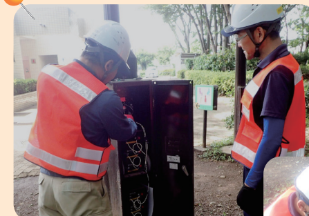
防災用照明灯点検
