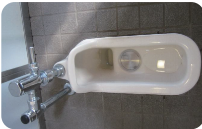
災害用トイレ(常設) 地下に便槽を持ち、災害時に給水や排水などのインフラが寸断された場合でも利用できるトイレです。
