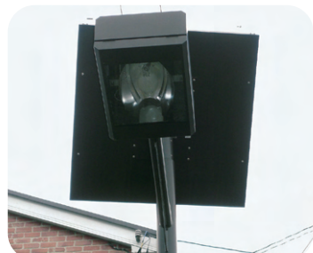
防災用照明灯 (ソーラー照明灯)
