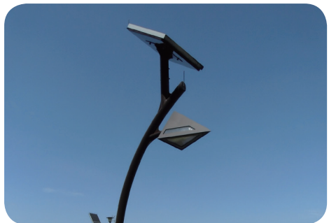
防災用照明灯 (ソーラー照明灯)
