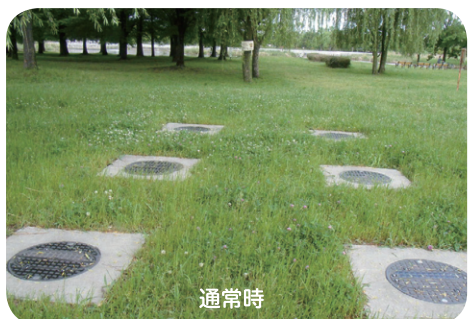
マンホール型災害用トイレ 災害時には、マンホールの蓋を外してテントを設置することにより仮設トイレとして使用することができます。
