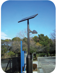
防災用照明灯 (ソーラー照明灯)
