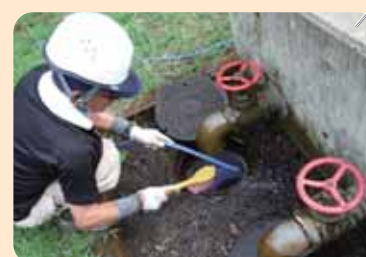
防災井戸の点検
