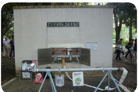
給水活動スペース（応急給水槽） 水道が被害を受けた場合に、応急給水活動を行うための施設です。
