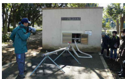
连接到水箱供水装置
