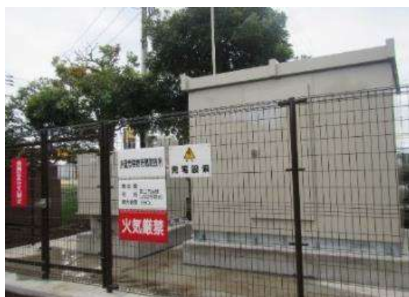
災害に備えた非常用発電機(秋留台公園)
