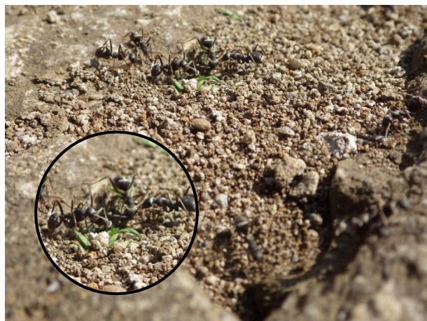
コンクリートの割れ目のアリの 巣：穴から砂を運び出している
